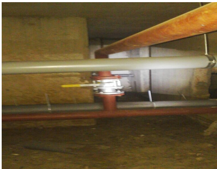
Ремонт внутрішньо будинкових інженерних мереж, у будинку на вул. Зої Гайдай, 7-Б
